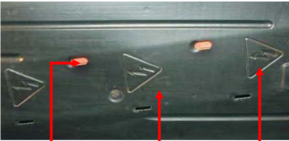
Yüksek Voltajlı Kablo Görünür
